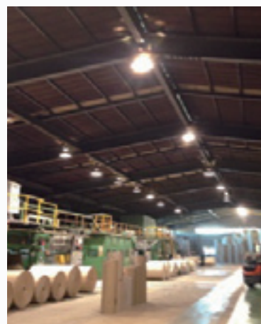
取替前 水銀灯 400W 20 台
